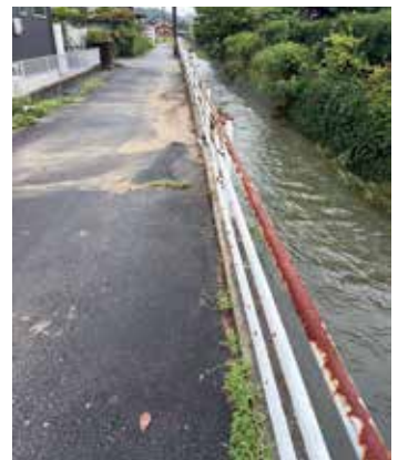
大雨による河川越流跡
