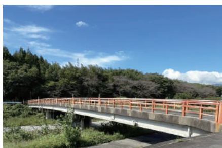
塗装が剥がれている弁天橋
