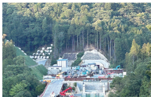
400トン／時の湧水のため、開通見通しを公表出来ない東海環状自動車道のトンネル
