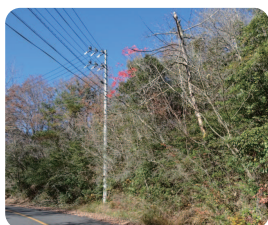
市道 米野～篠立線の立ち枯れ樹木
