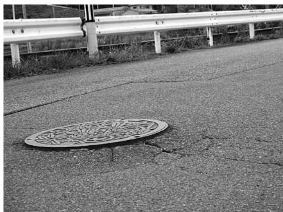
隆起したマンホール
