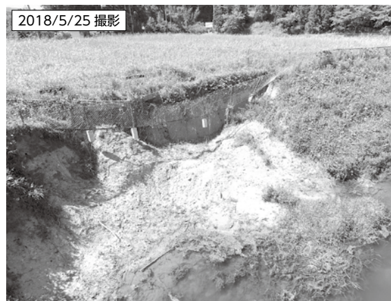
うっと溜池（通称）の法面が崩れ、壊れているフェンス
