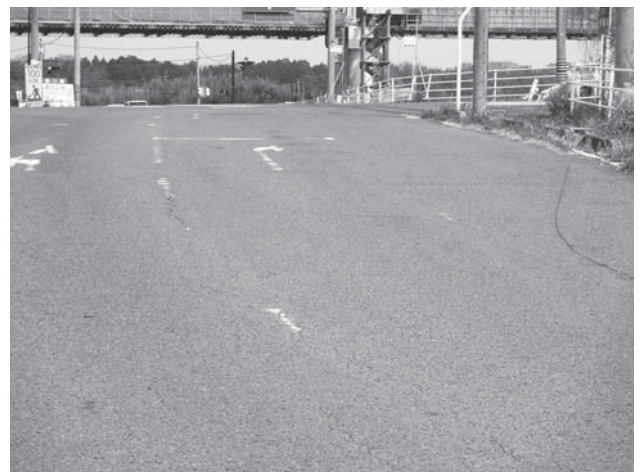
路面標識が消え危険な道路
