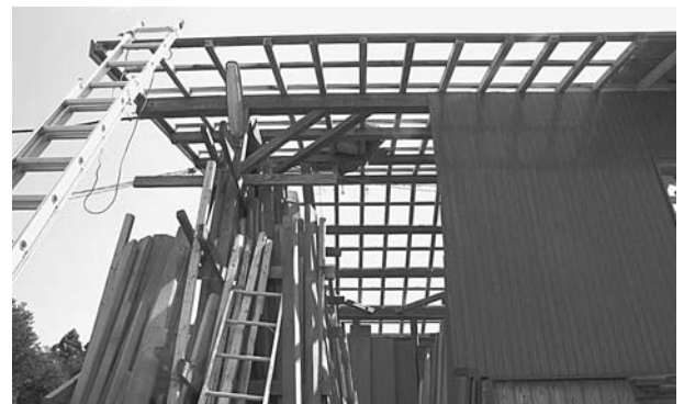
竜巻で屋根が飛ばされた家屋（大貝戸地区）
