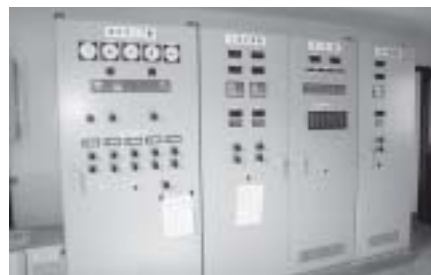
上水道管理機器（藤原浄水場）
