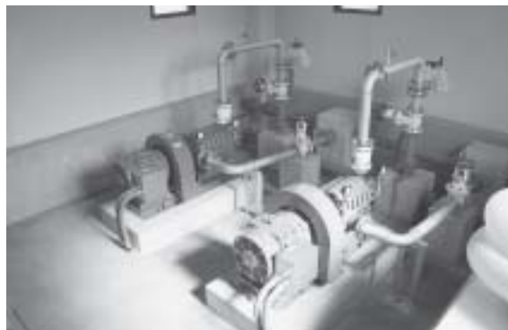
水道施設のポンプ
