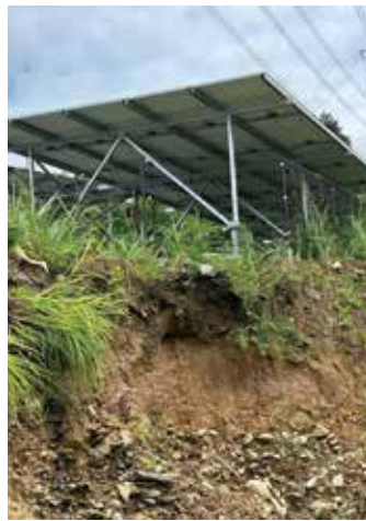
市内の太陽光発電所
