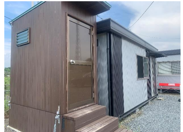
↑いなべ営業所に設置されたバイオトイレ。バイオトイレとは、人間の排泄物を微生物の動きによって分解、処理するトイレのこと。
