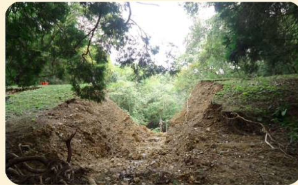
大雨により決壊したため池
