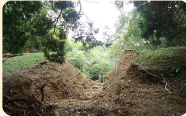
大雨により決壊したため池
