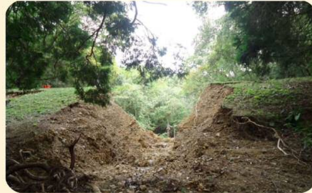
大雨により決壊したため池
