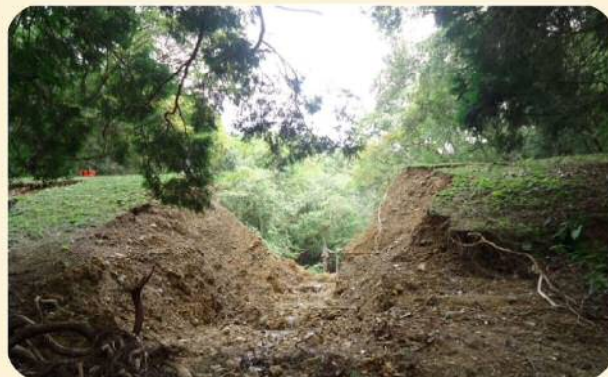
大雨により決壊したため池
