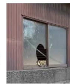
窓が割れた管理不全空家
