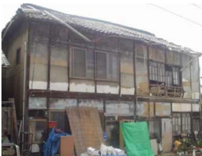
・長期間、人が住んでいない空家
