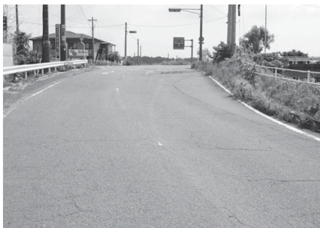
道路標示の消えた市道
