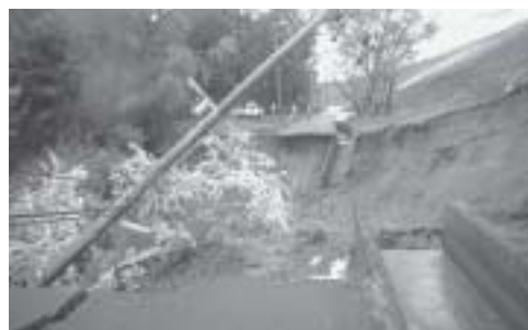
員弁町内の災害現場 (平成18年4月の災害)
