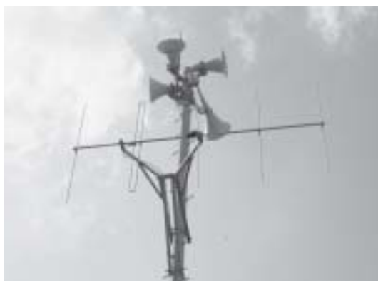
員弁町地内に設置されている防災無線
