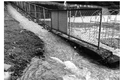
西藤原小学校の大雨被害
