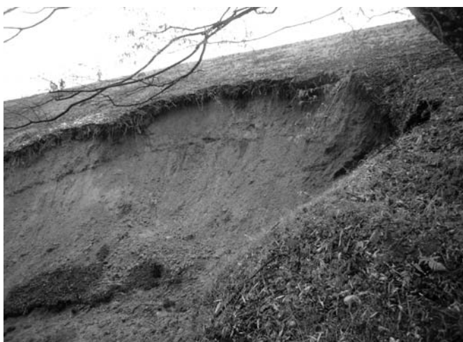
笠田大溜の堤体の一部崩壊の様子
