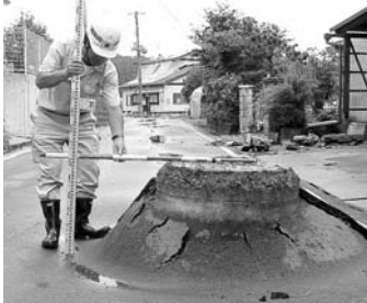
▲60cmも盛り上がったマンホールの状況
