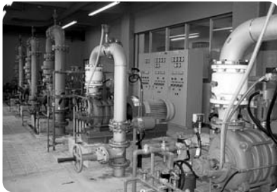
▲配水施設から水を送ります。
