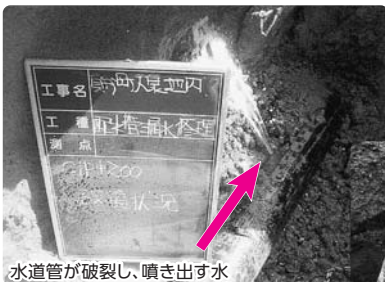
水道管が破裂し、噴き出す水
