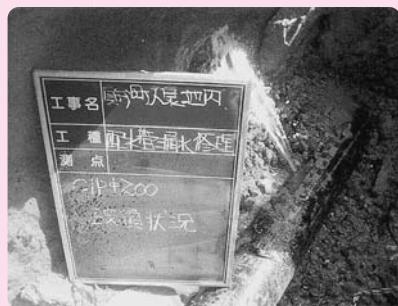
▲老朽化した水道管
