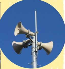
防災用屋外 スピーカー
