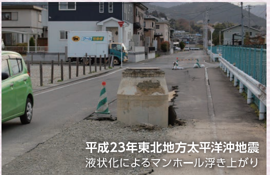
平成23年東北地方太平洋沖地震 液状化によるマンホール浮き上がり 液状化により、建物が沈下して傾いたり、道路にあるマンホールなどが飛び出たりすることで、地震後の生活に大きな悪影響をきたします。
