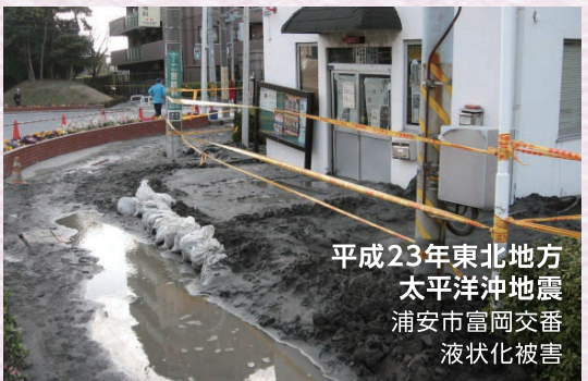
平成23年東北地方太平洋沖地震 浦安市富岡交番 液状化被害 地震による強いゆれにより、地盤の中の水分と砂の関係がくずれ、地盤が水になってしまうことを「液状化」といいます。
